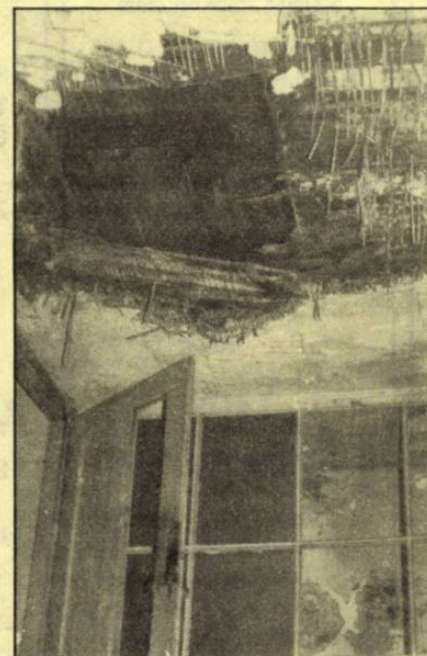
Szakad a tető...
